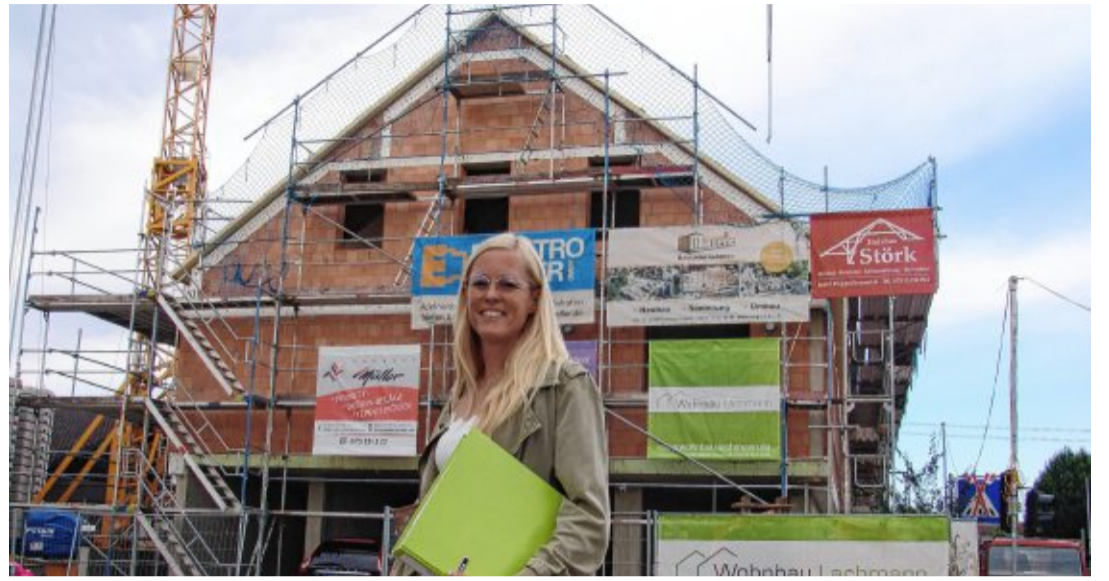
Margit Lachmann vor dem Gebäude in der Bahnhofstraße 16 in Mimmenhausen. Im März ist die Fertigstellung geplant. BILDER: MIRIAM ALTMANN
